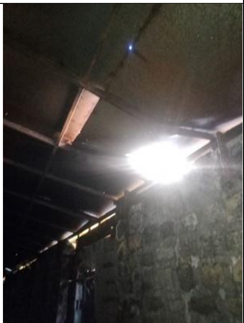
Toiture abîmée au-dessus de la porte d'entrée
