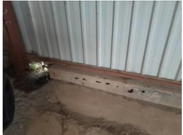
Altération des blocs agglos en pied de bardage
