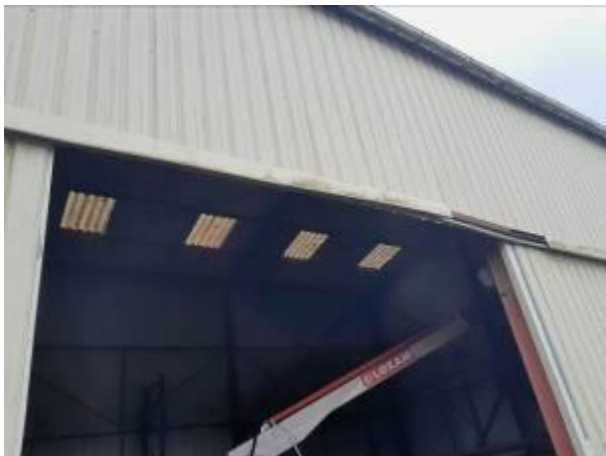
Désolidarisation couverture du rail supérieur grande porte
