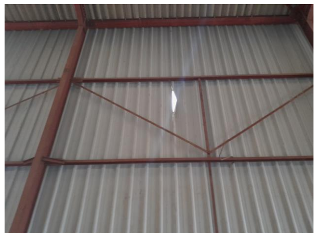
Ouverture dans la tôle de bardage
