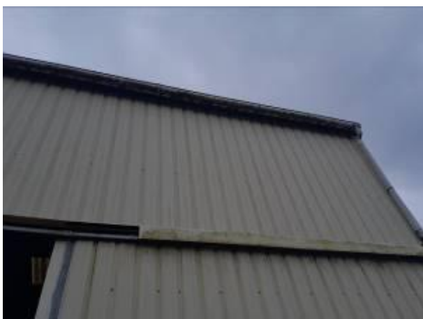
Trace d'humidité en sous-face de gouttière
