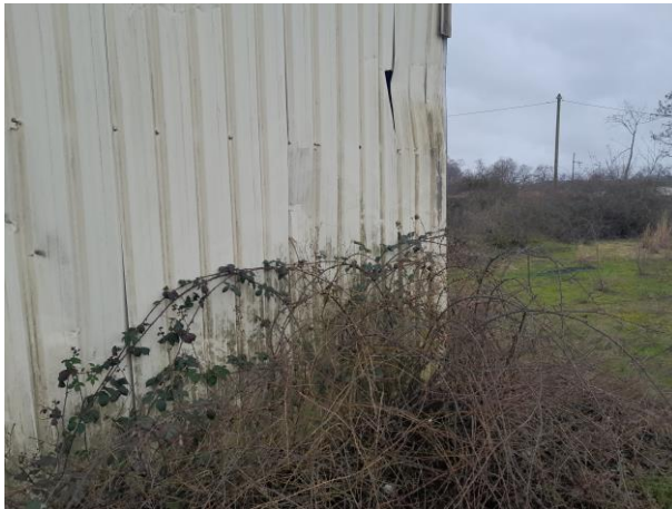
Désolidarisation cornière d'angle bardage
