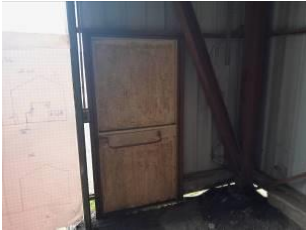
Piqûre de rouille sur porte d'accès
