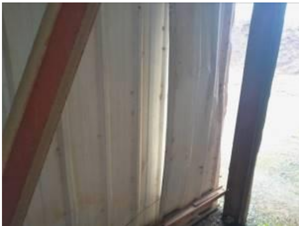
Déformation de tôle avec entrebâillement
