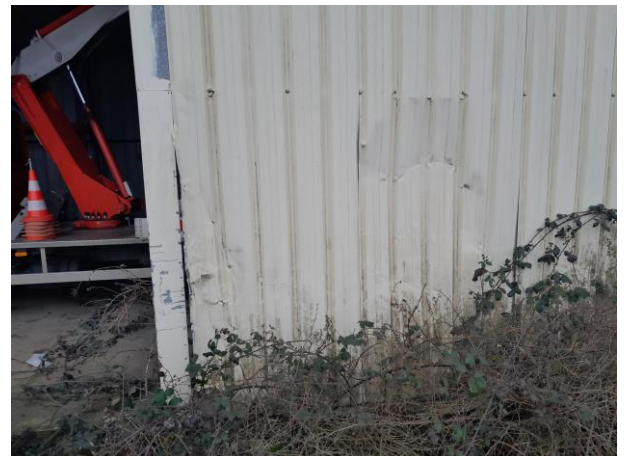
Chocs, développement de végétation
