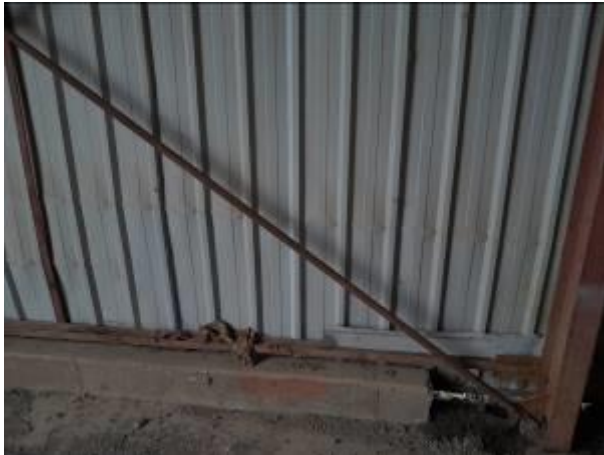
Déformation linéaire du bardage
