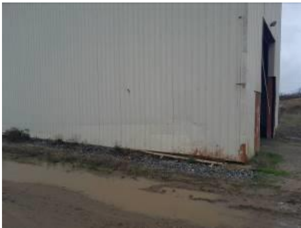
Déformation linéaire et traces d'oxydation
