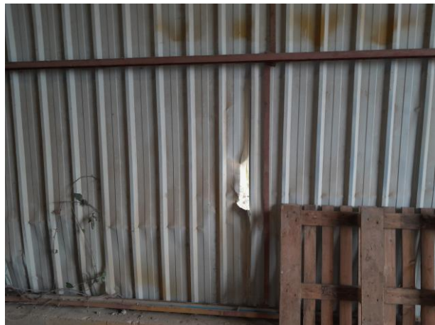
Choc et ouverture dans la tôle de bardage
