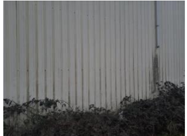
Trace d'humidité sortie descente EP sur bardage
